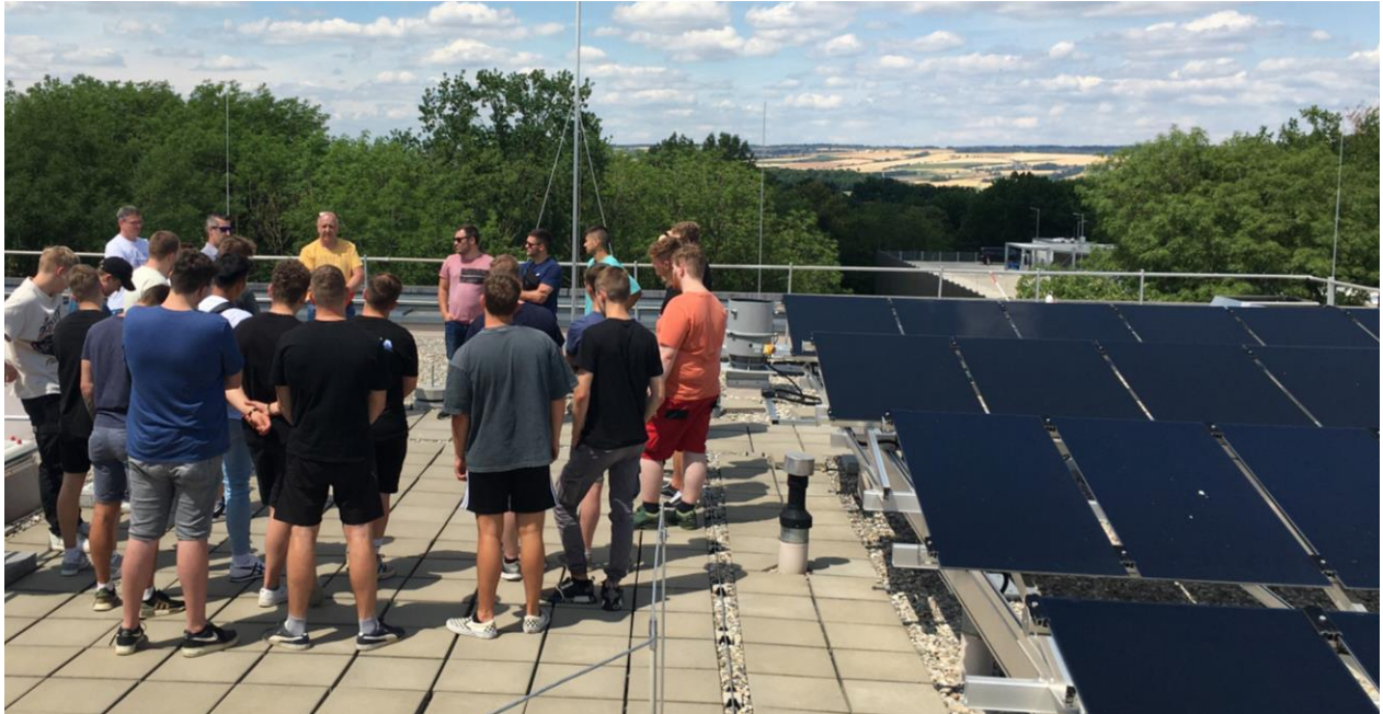
Photovoltaikanlage mit Blitzschutz
